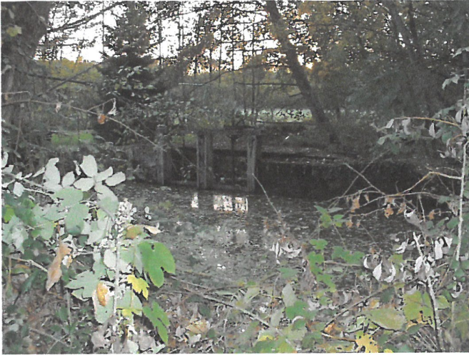
Vannage de décharge en amont direct du moulin
